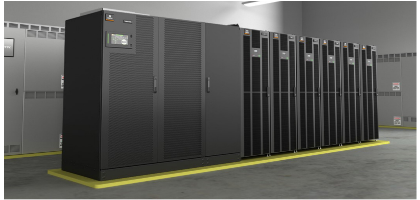
维谛HPL锂电池搭配Liebert EXLS1 1200kW UPS系统
