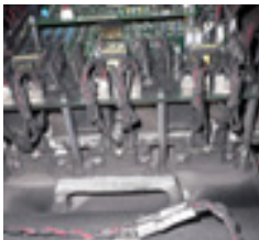
传统UPS内部积灰状态
